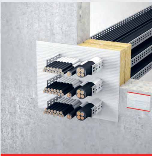
Kabelschott in einer Betonwand
