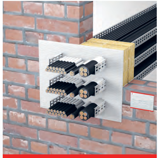
Kabelschott in Mauerwerkswand
