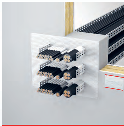
Kabelschott in leichter Trennwand
