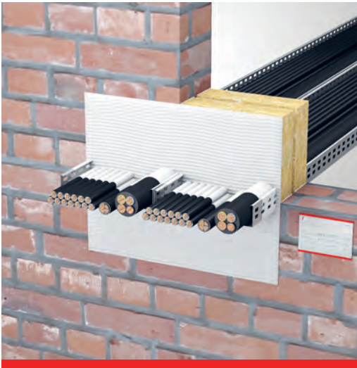
Kabelschott in Mauerwerkswand
