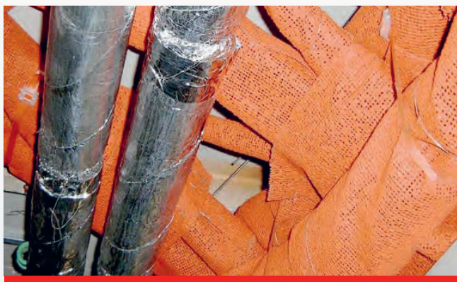
Äußere Umwicklung von Kabelbündeln mit Kabelaus-/Eingängen
