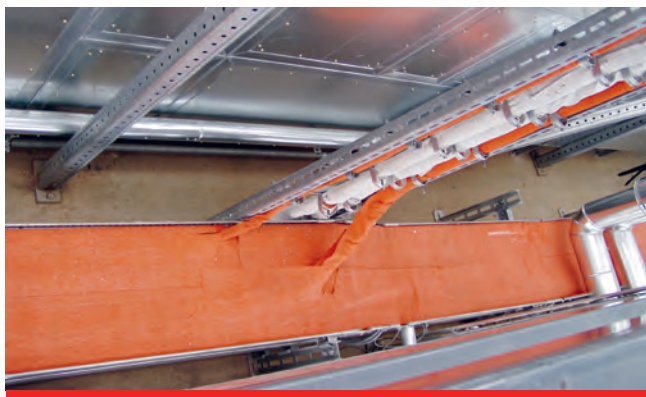
Äußere Umwicklung einer Kabelbahn, aufgelegt auf Konsolen
