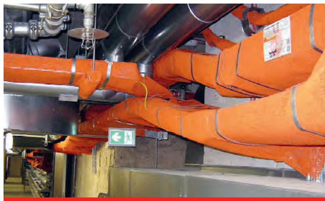
Äußere Umwicklung einer Kabelbahn und der Tragekonsolen
