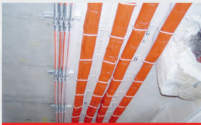
Kabelbandage unter einer Decke
