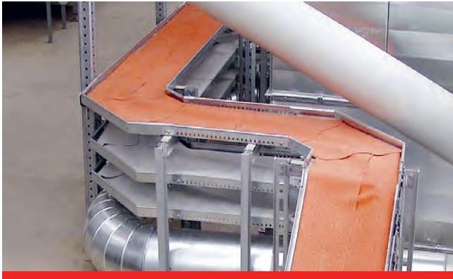
ISITHERM Kabelbandage eingelegt in eine Kabeltrasse
